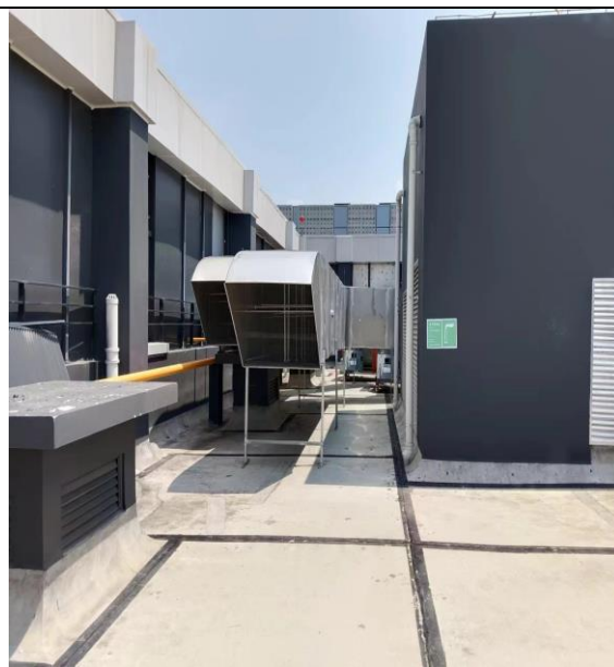
食堂油烟排气筒
