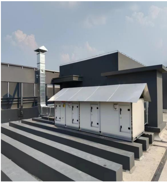
生产废气排气筒
