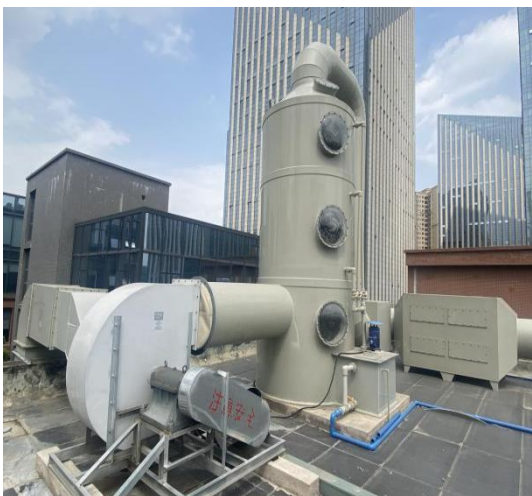
喷淋塔+两级活性炭吸附装置
