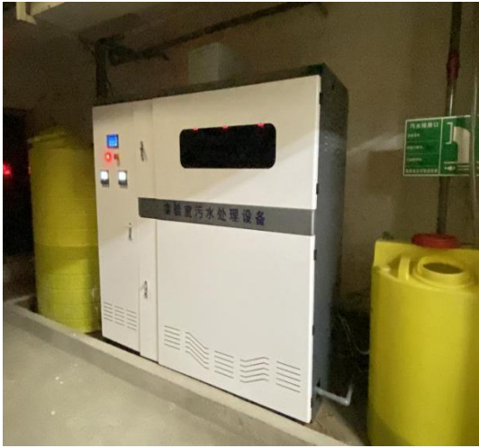
一体化污水处理设备
