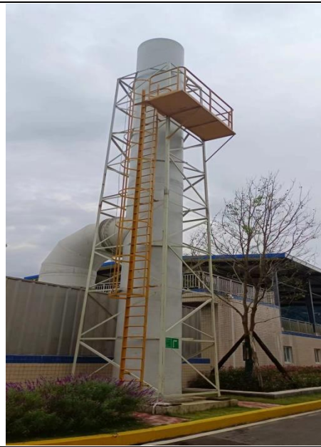
二期废气排气筒
