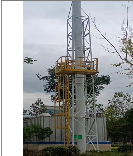
一期废气排气筒
