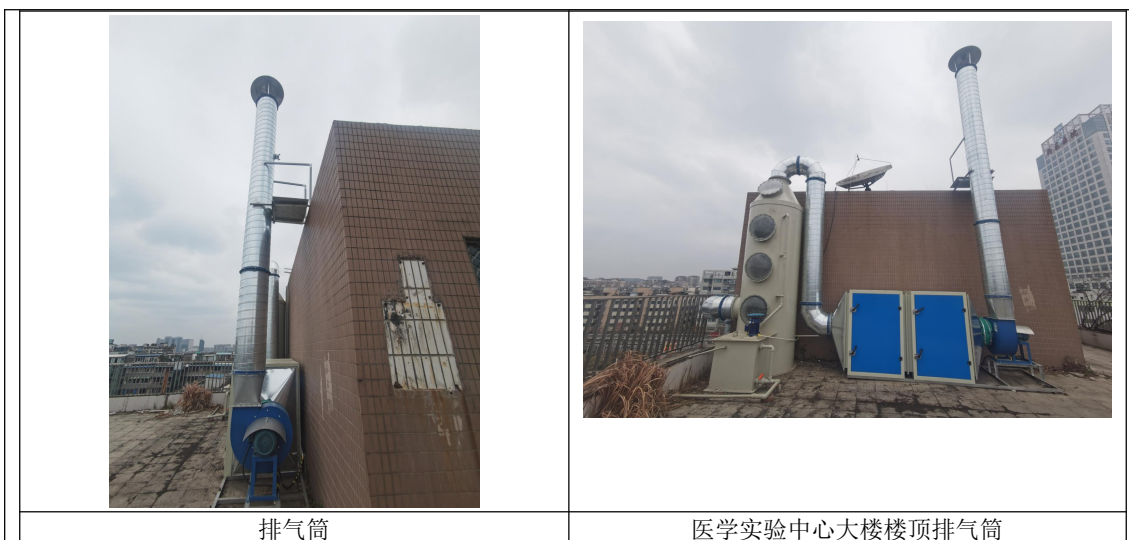
图 3-1VOCs 废气治理设施图
