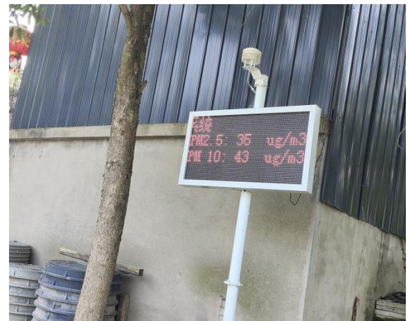
扬尘在线视频监测系统
