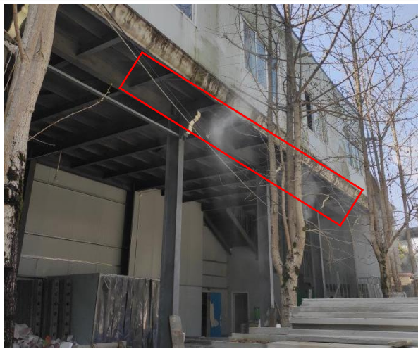
喷淋降尘装置
