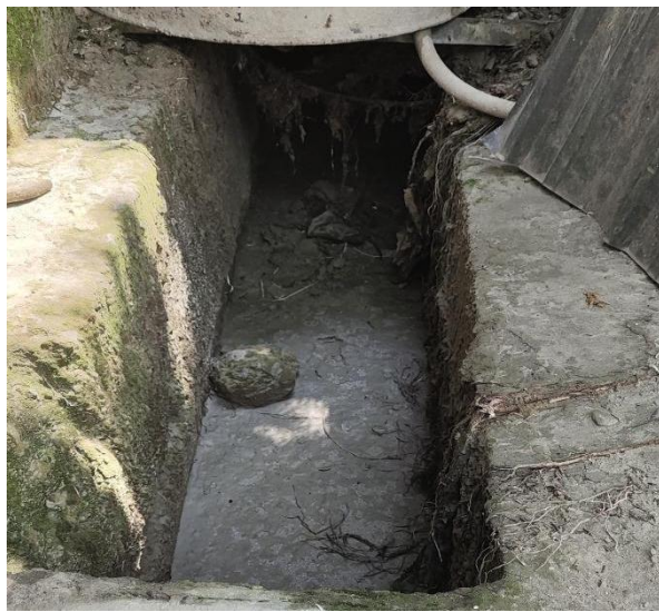
雨水收集沟+沉淀池
