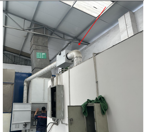
油漆库房废气收集管道
