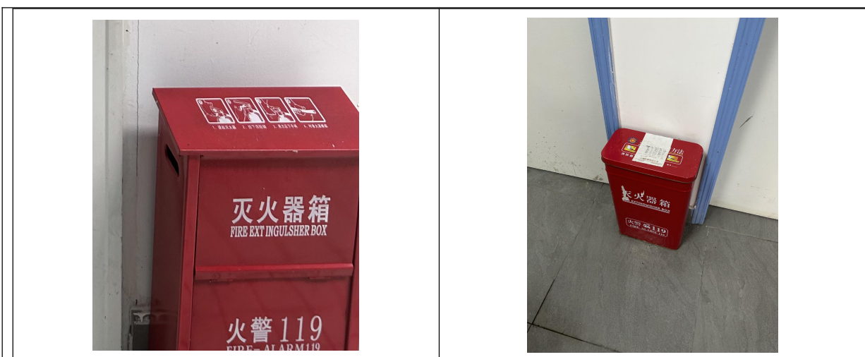
图 3-7 灭火器材现状照片
