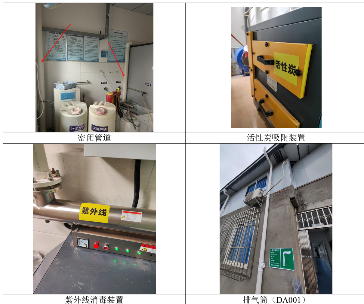
图 3-1 废气处理措施现状照片
