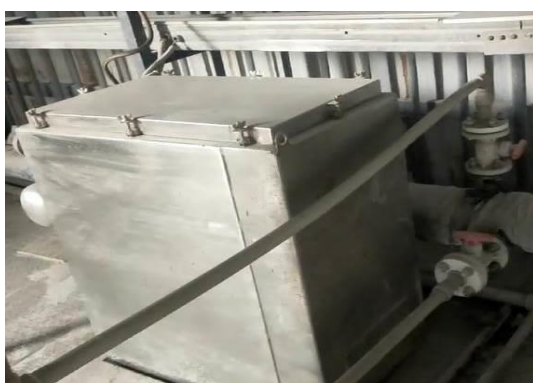
缓冲仓仓顶除尘器
