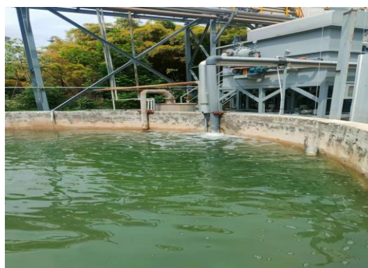
污水处理站出水口及回用水池
