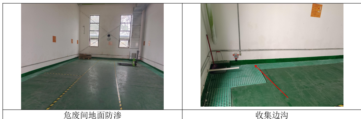
图 3-8 地下水污染防治措施现状图
