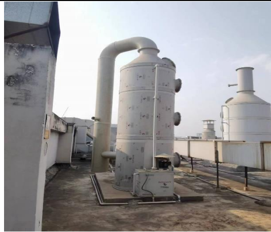
活性炭吸附+碱液喷淋塔系统+排气筒
