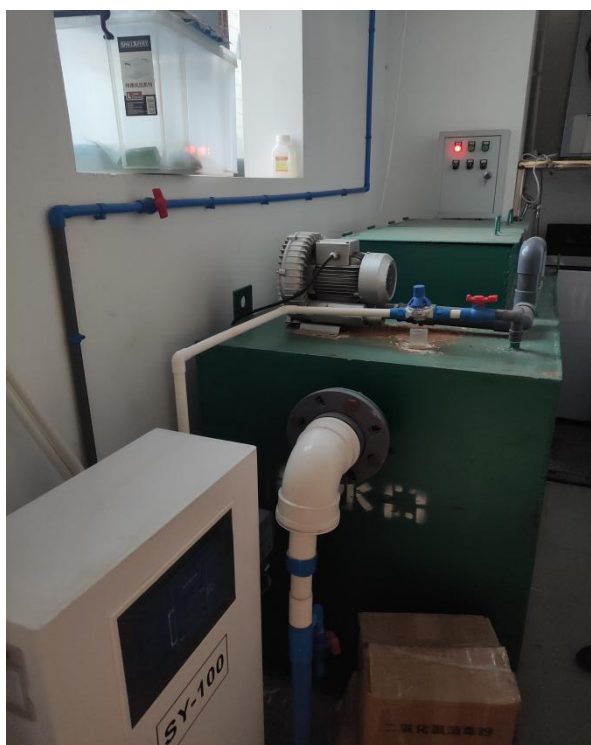
污水处理设施
