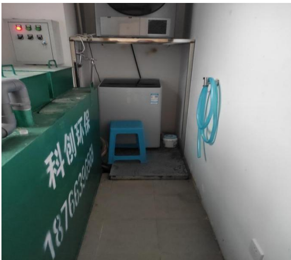
污水处理设施
