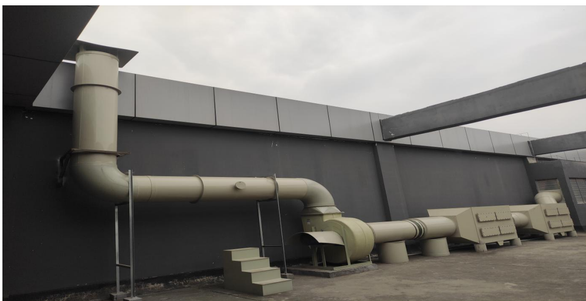
活性炭活性炭吸附装置+排气筒（DA001）
