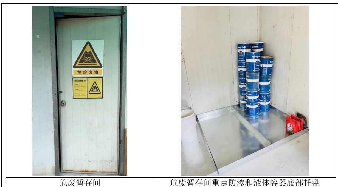
图 3-2 危废暂存间环保设施图
