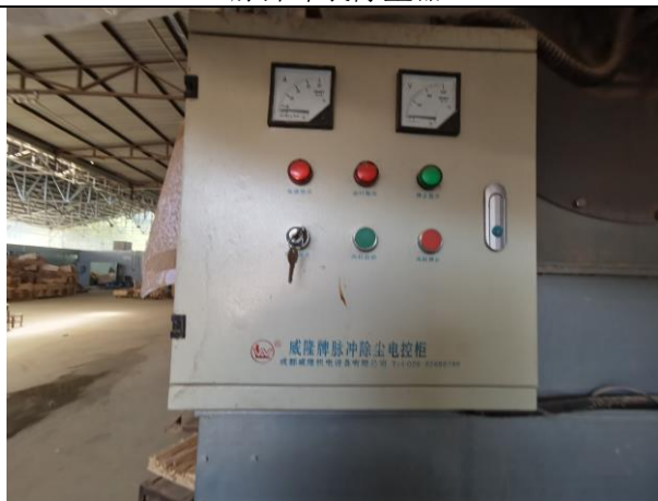
脉冲布袋除尘器控制电箱
