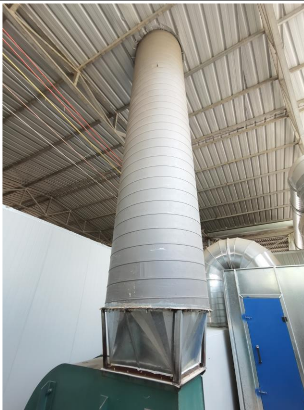
有机废气排气筒 DA002
