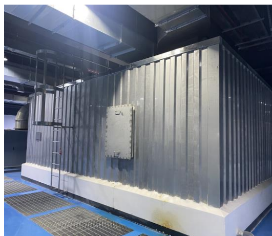
预处理单元生物除臭装置
