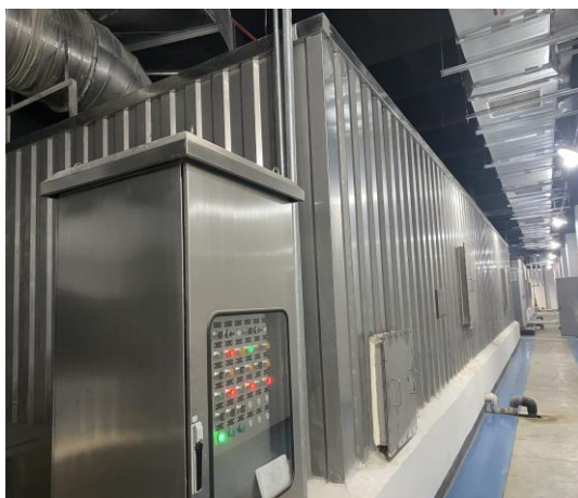
污泥处理单元生物除臭装置
