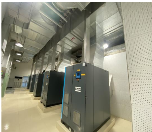
图 4-4 鼓风机房吸音措施
