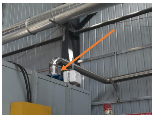
烧结炉上的排风管
