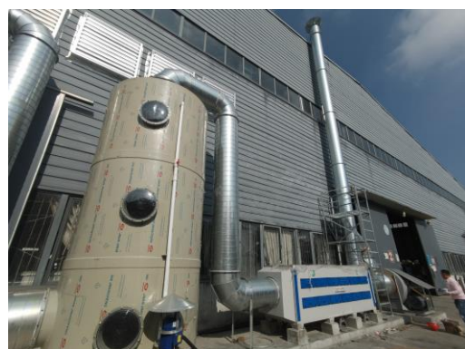
两级碱喷淋+两级活性炭+16.5 排气筒（DA005）
