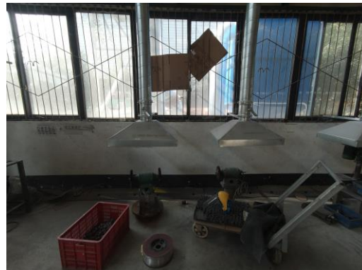
角磨机和打磨机废气收集装置
