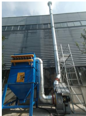
脉冲布袋除尘器+16.5m 排气筒 (DA004)
