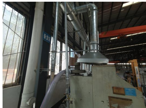
箱式喷砂机废气收集装置
