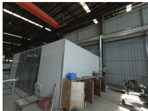
手工喷塑房和其上部的废气风管
