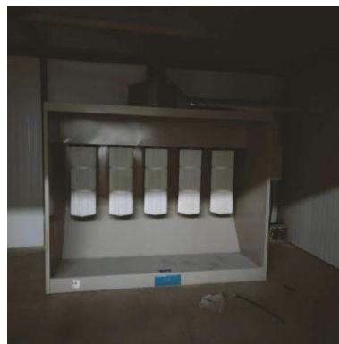
手工喷塑房内喷塑粉尘滤筒除尘器
