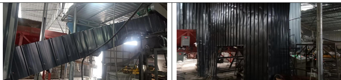
水泥筒仓及输送带搅拌机密闭
