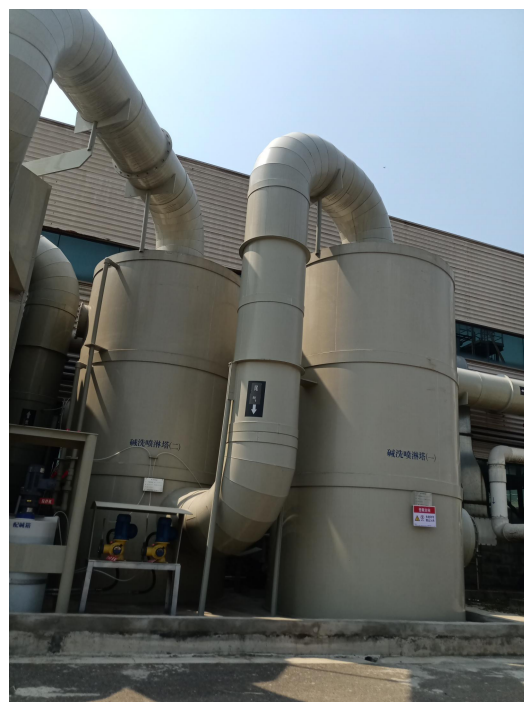
废气处理系统（新建）
