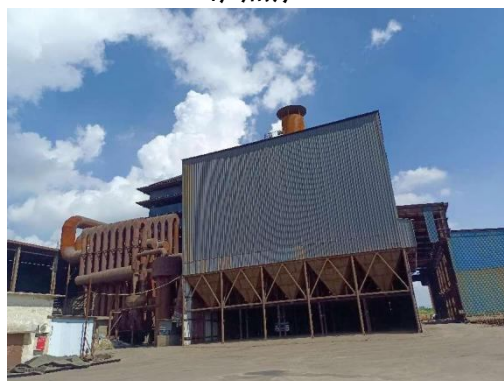
矿热炉烟气处理装置
