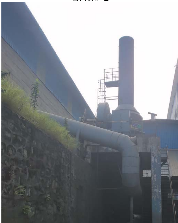
粉矿仓喷淋除尘器
