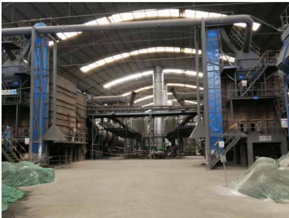
钛精矿烘干设备及排气筒
