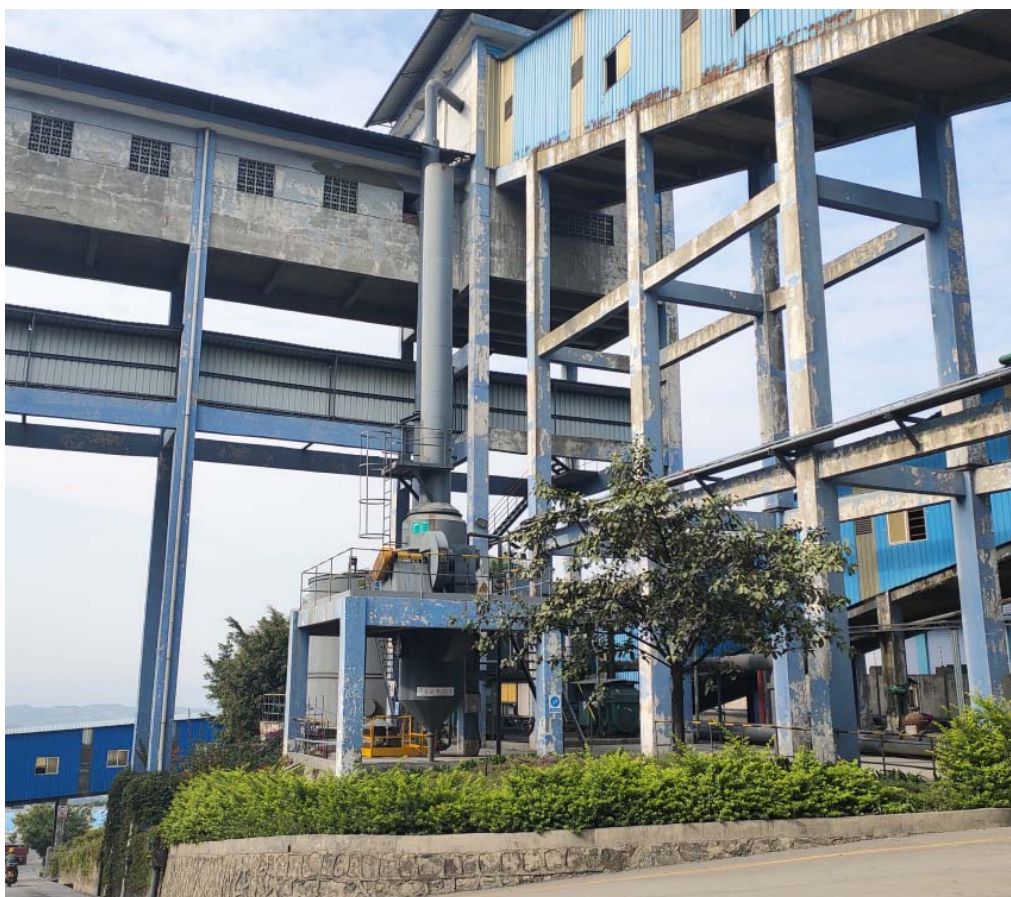
皮带转运除尘器
