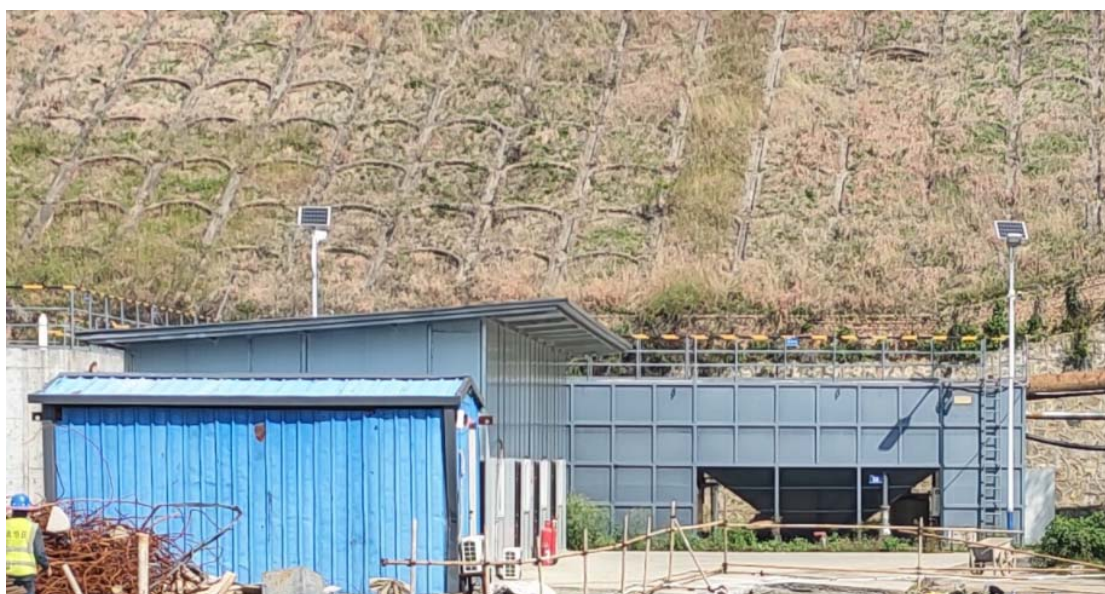
一体化生化处理装置
