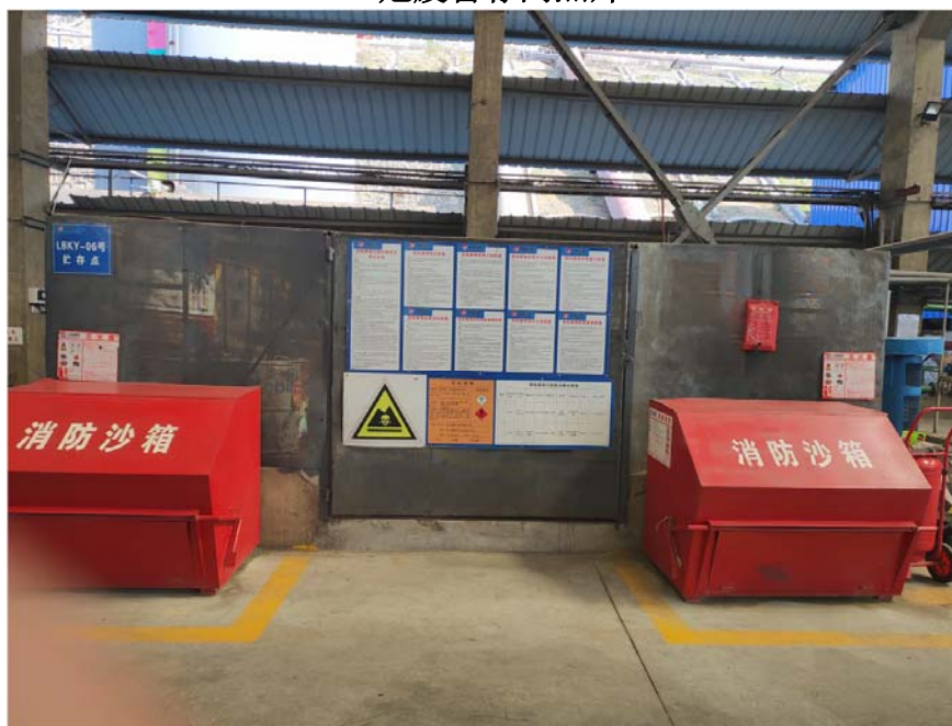
2#危废暂存间照片
