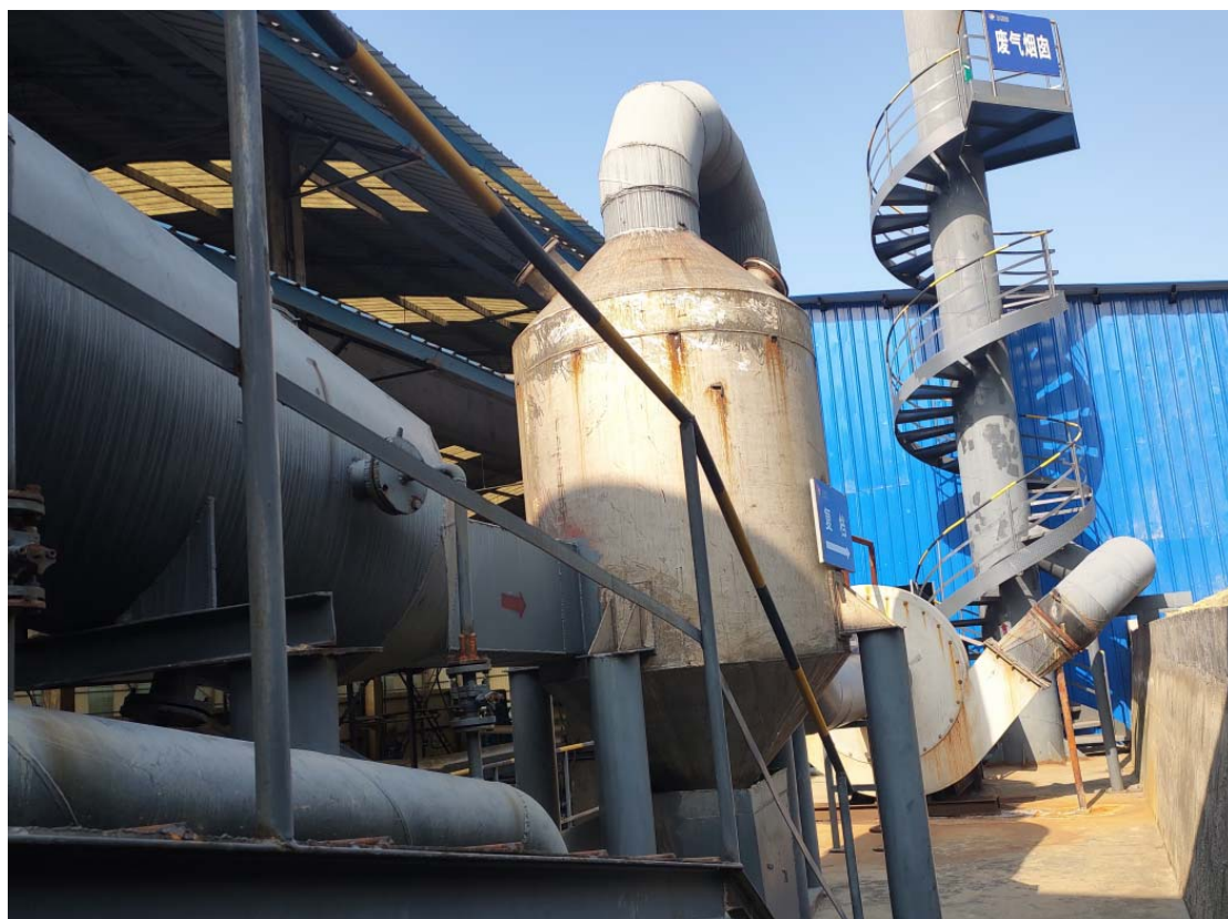
药剂制备废气复喷洗涤器+复挡除沫器装置
