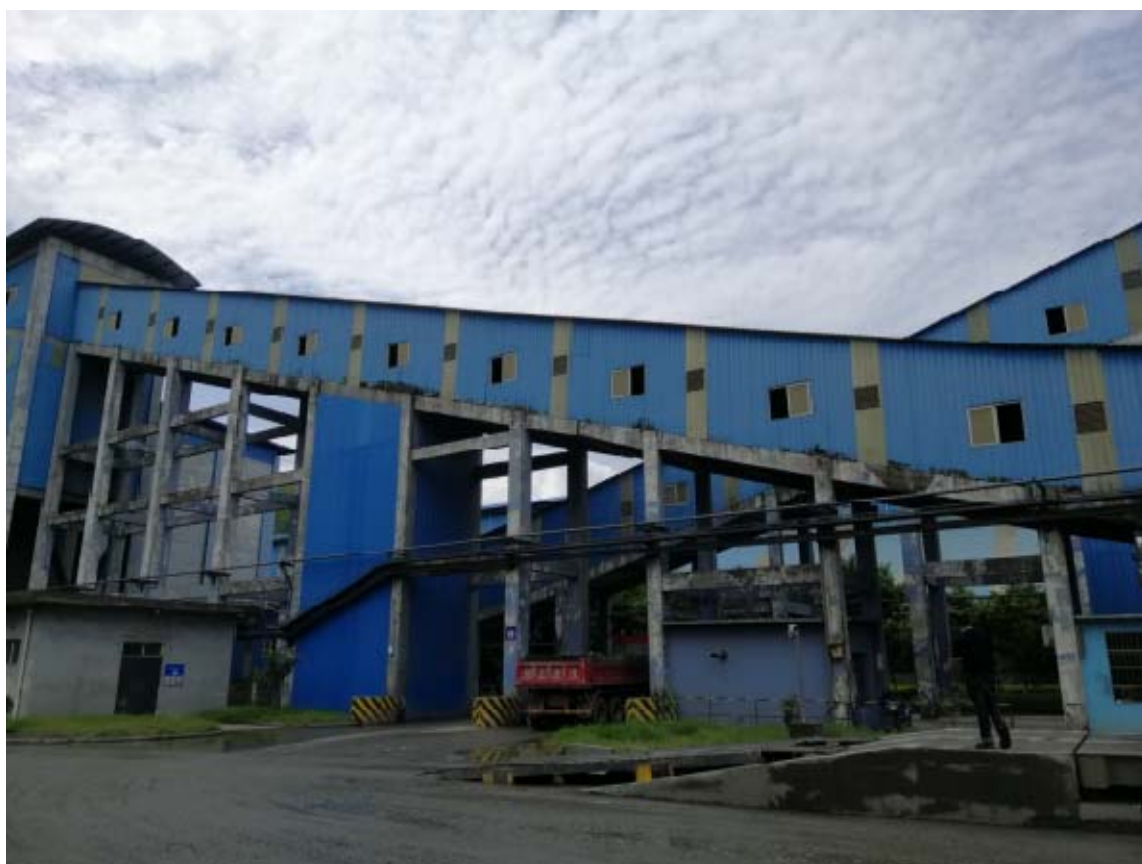
皮带运输通廊
