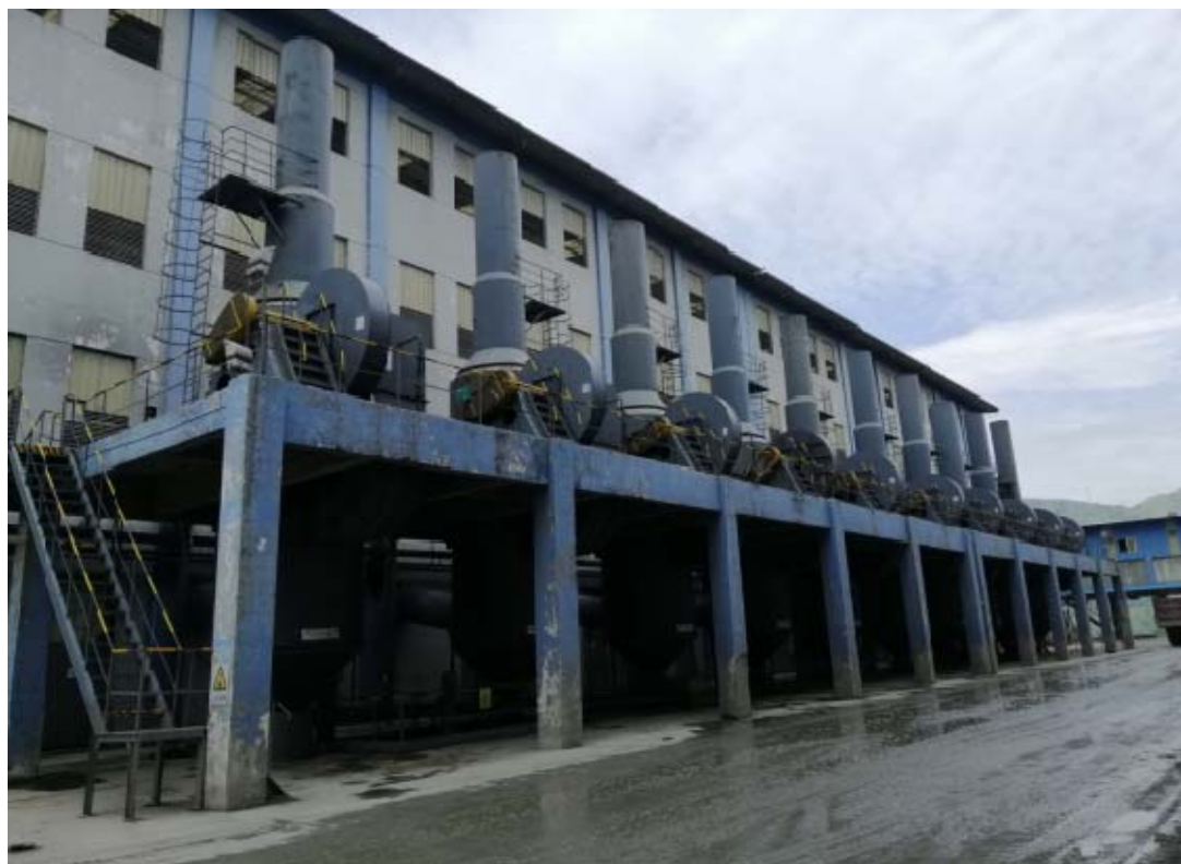
现有破碎筛分车间排气筒
