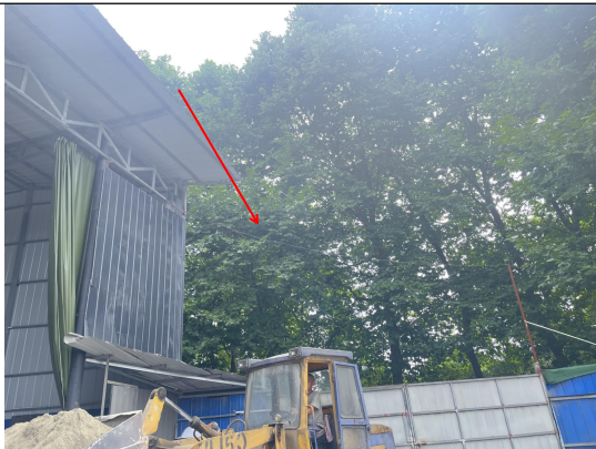
喷雾除尘装置
