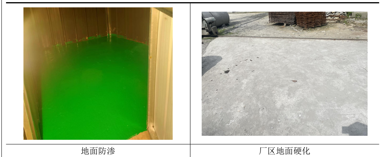
图 3-6 地下水污染防治措施现状图
