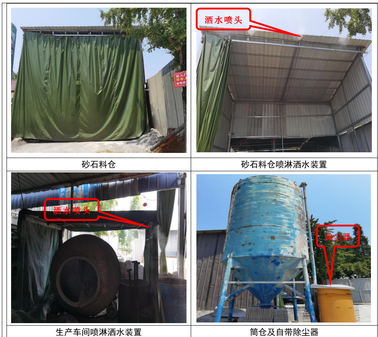
图 3-2 废气收集、处理设施
