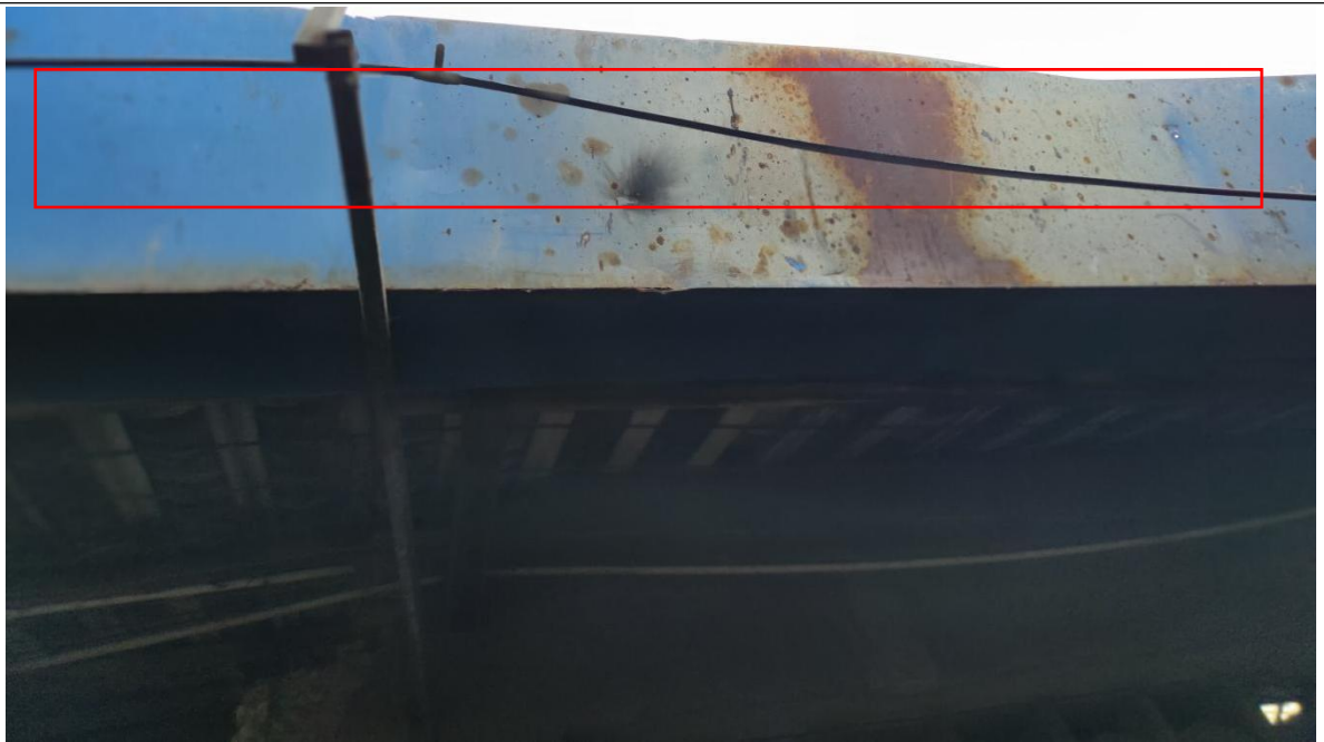
喷淋降尘装置
