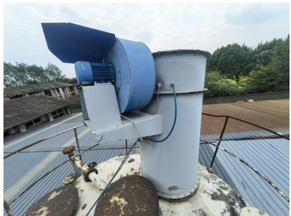
筒仓顶部除尘器
