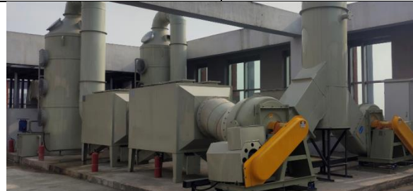
2 套碱液喷淋塔+2 套过滤棉+2 套二级高效活性炭吸附系统
