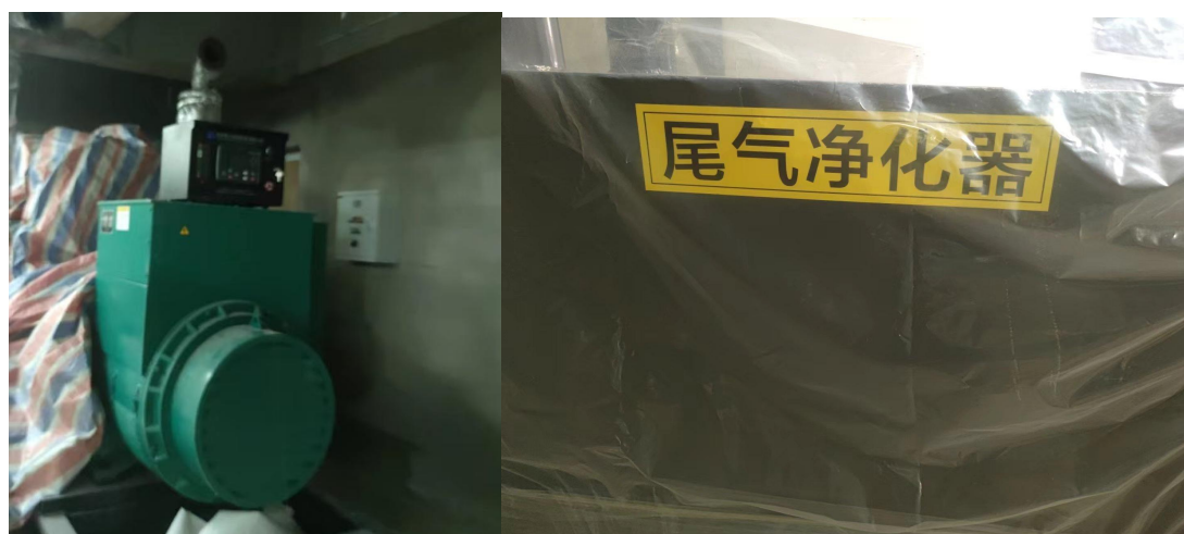
图 3-2 柴油发电机及尾气净化装置
