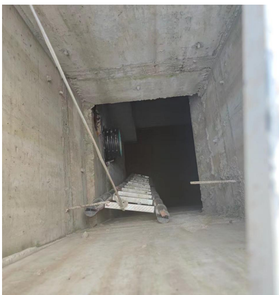
图 3-1 生活污水预处理池
