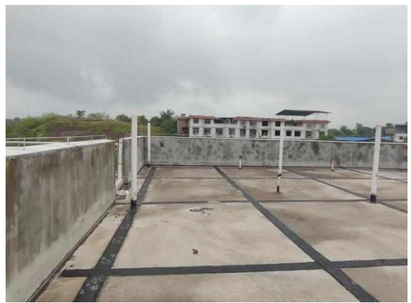
医疗废物暂存间 恶臭楼顶排气口
