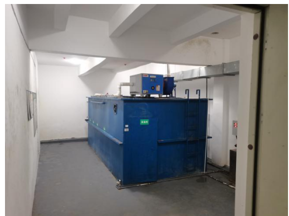
污水处理设施
