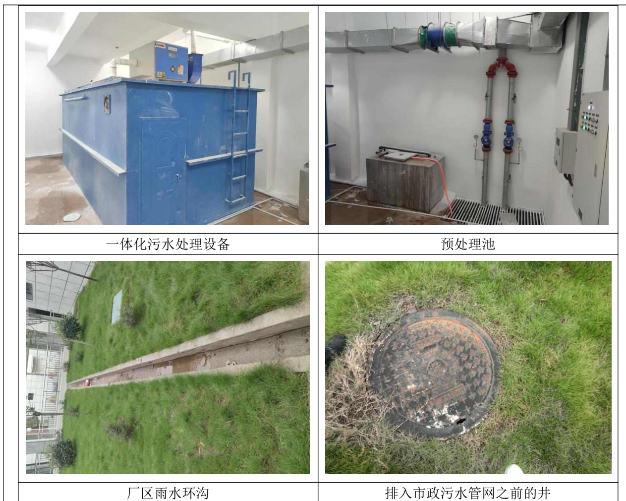
图 3-3 本项目废水治理措施现场照片
