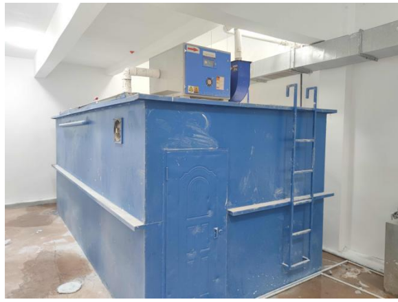
一体化污水处理设备密闭
