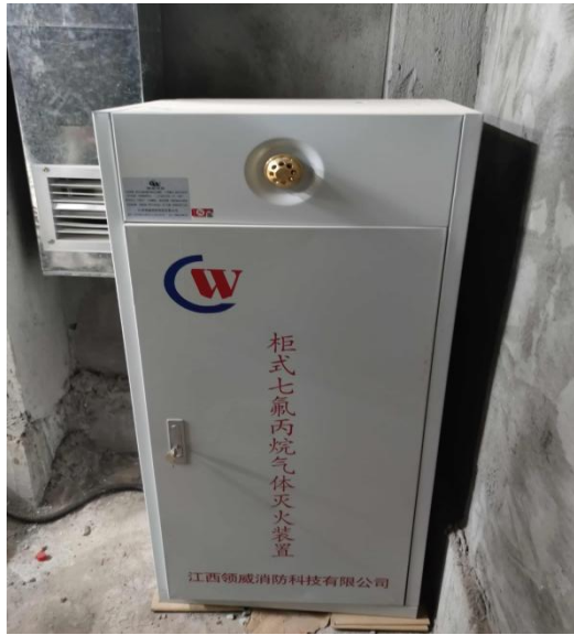
发电机房灭火装置
