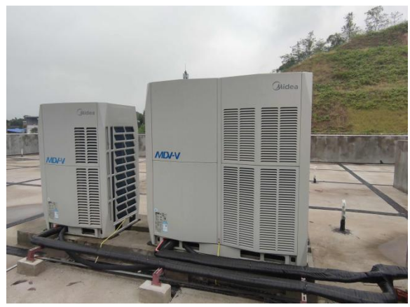
空调系统置于楼顶
