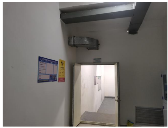
一体化污水处理设备封闭大门
