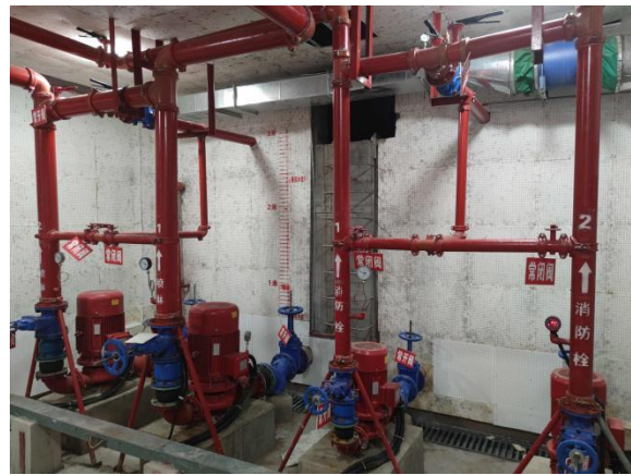
消防水泵基础减震
