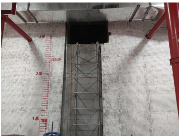
本项目消防水池
