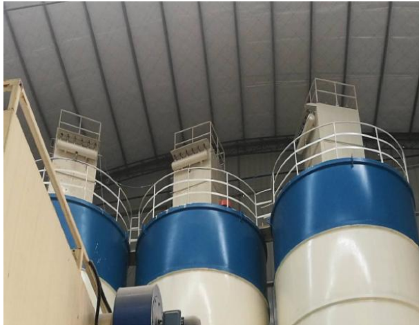
筒仓-袋式脉冲除尘器
