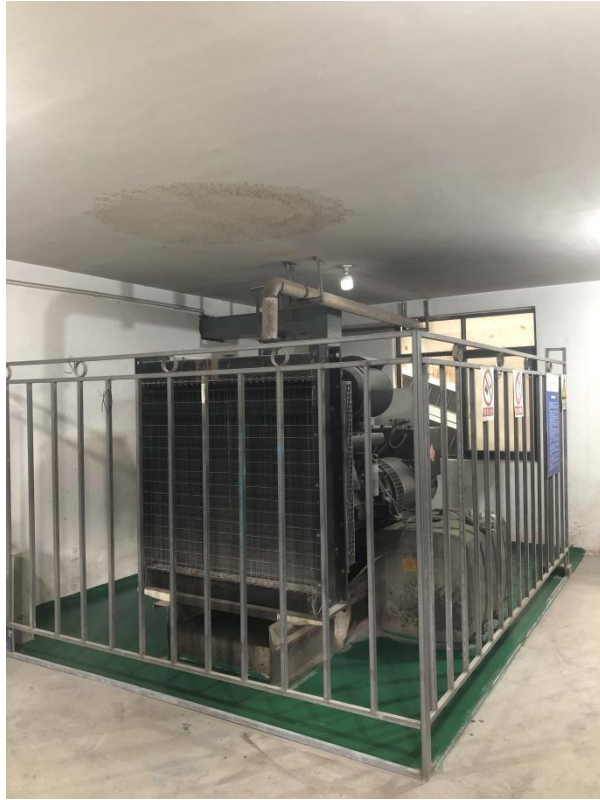
柴油发电机房+储油间
