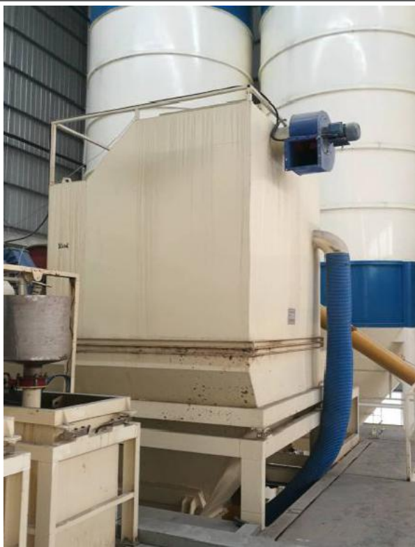
搅拌主机-袋式脉冲除尘器
