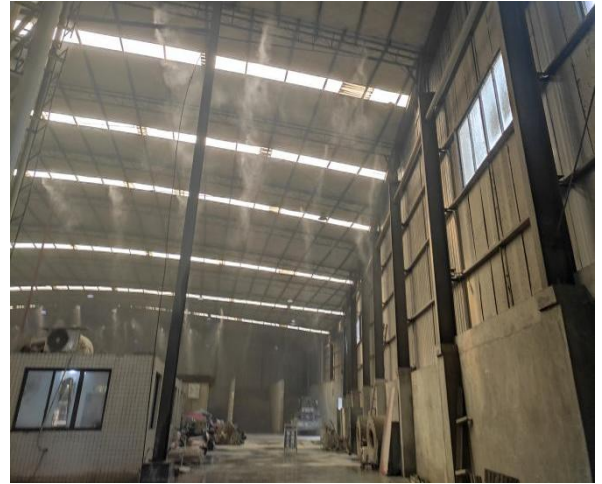
搅拌楼-喷淋洒水装置
