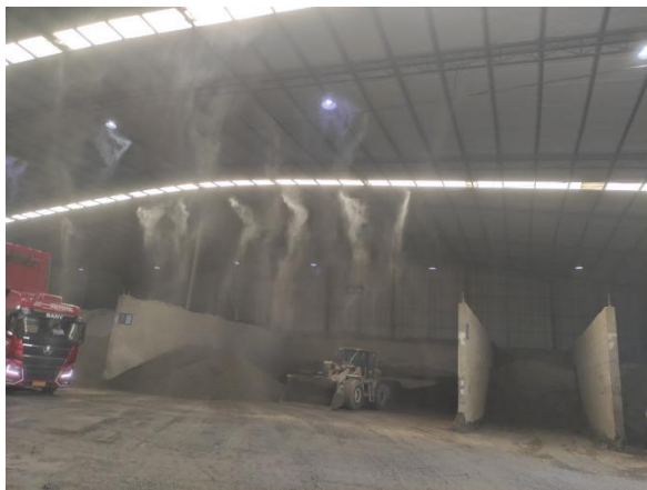
卸料区--喷淋洒水装置
