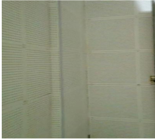
柴油发电机隔声墙壁
