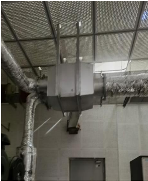
发电机除尘装置
