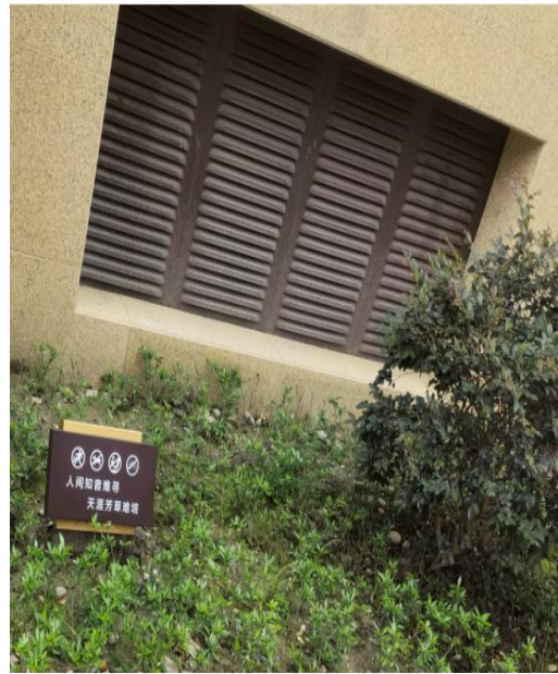
地下车库通风装置
