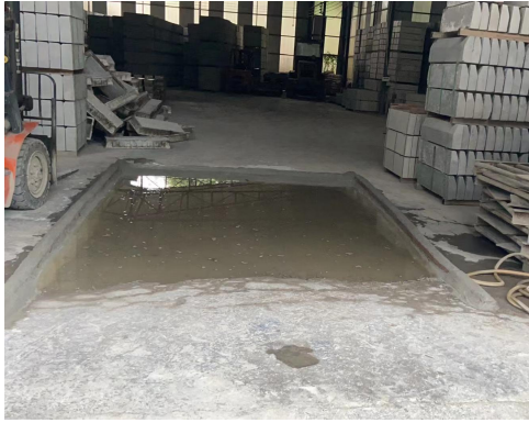
洗车废水隔油沉淀池
