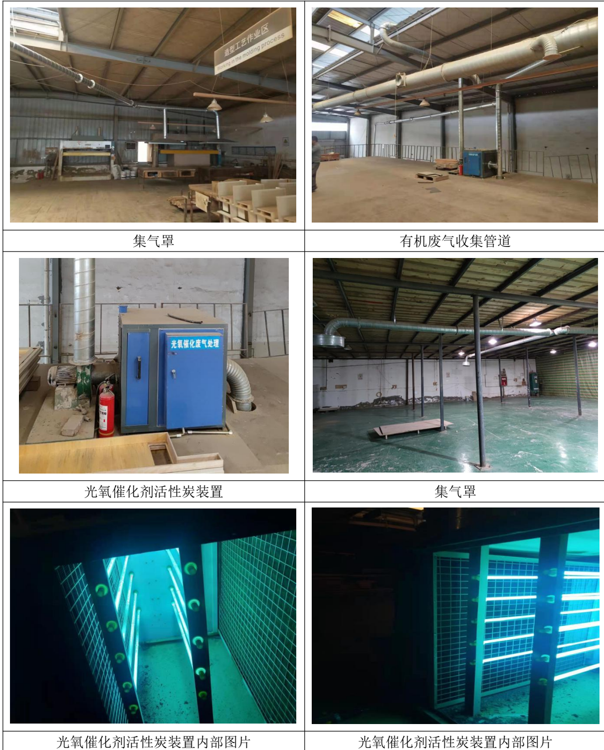
图 3.2 有机废气收集处理现场照片
