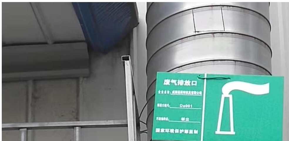
中央除尘器排放口
