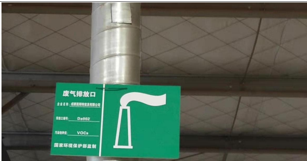
有机废气排放口
