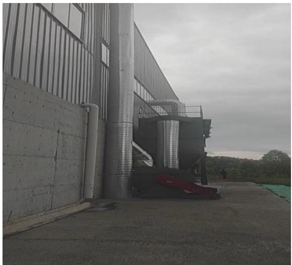
布袋除尘器及排气筒
