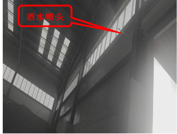
车间喷淋洒水装置
