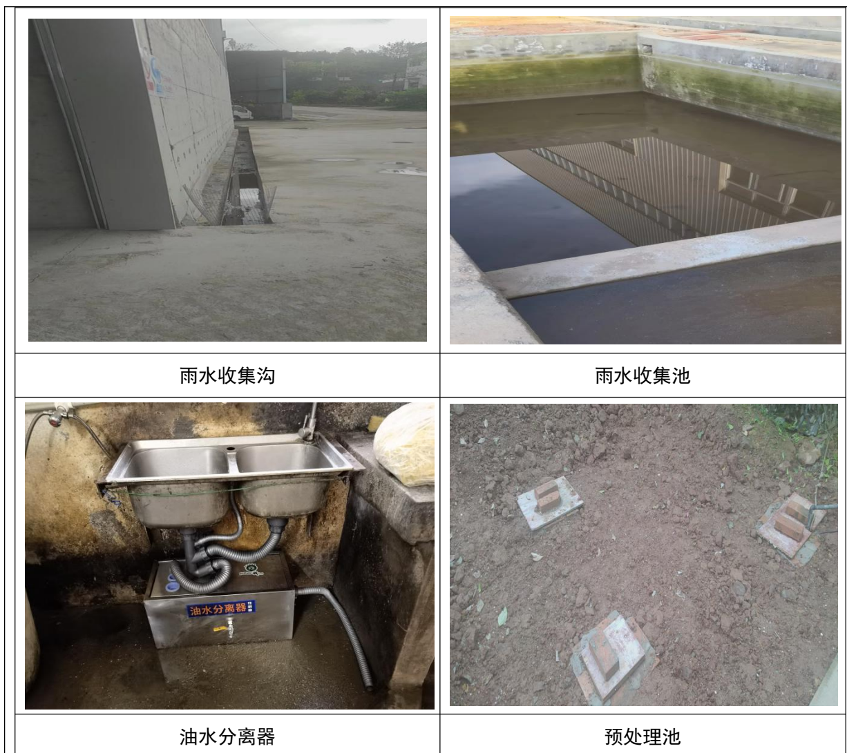
图 3-1 废水处理设施
