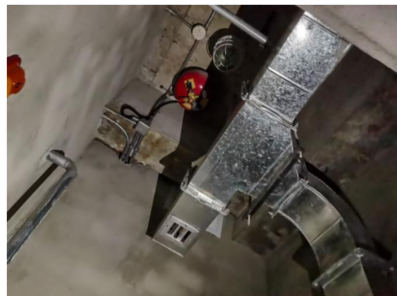
储油间柴油可燃气体报警器
