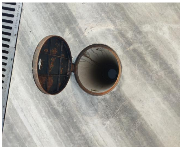
1#地下水监测井
