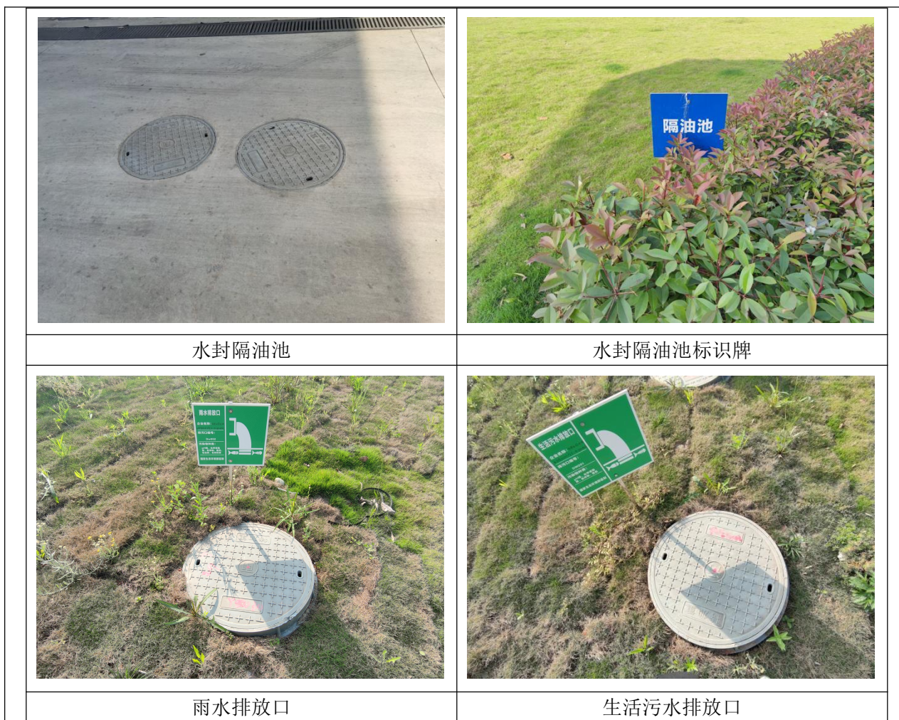
图 3.3 本项目废水治理措施现场照片
