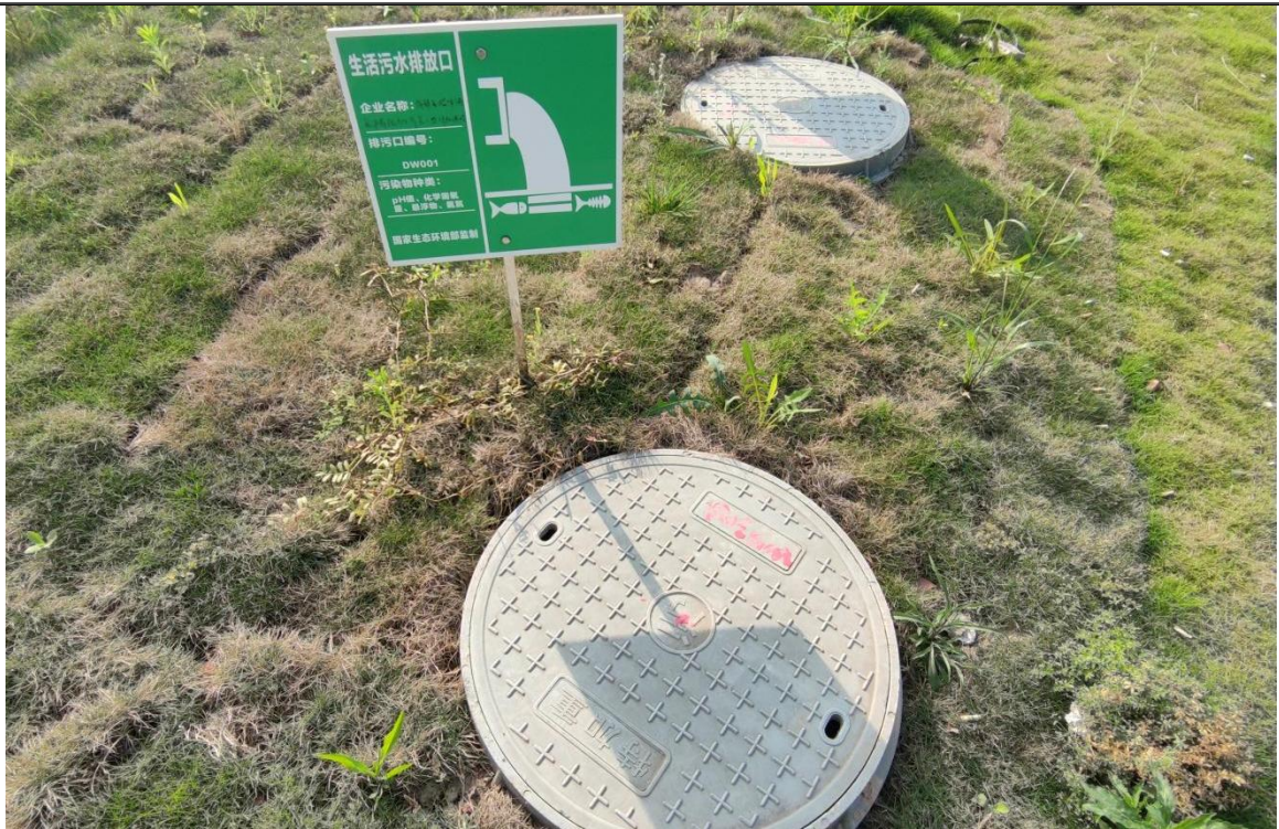
生活污水排放口
