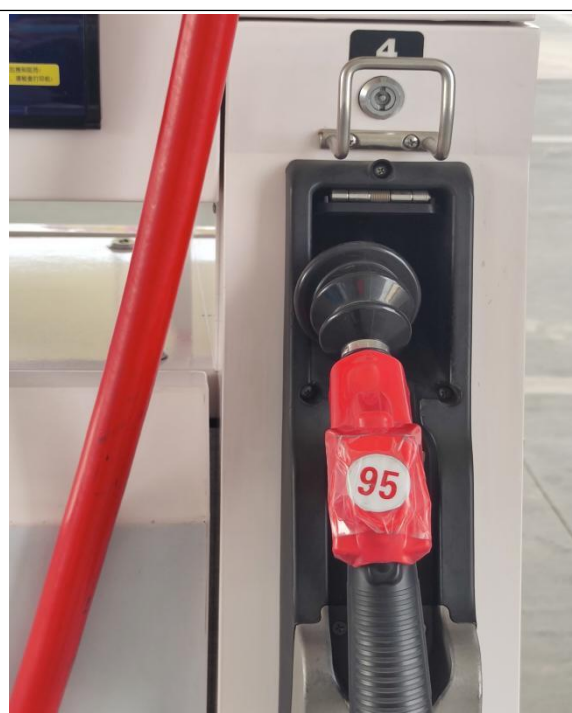
二次油气回收系统
