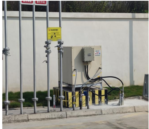
三次次油气回收系统 (OPW 油气回收后端处理系统)
