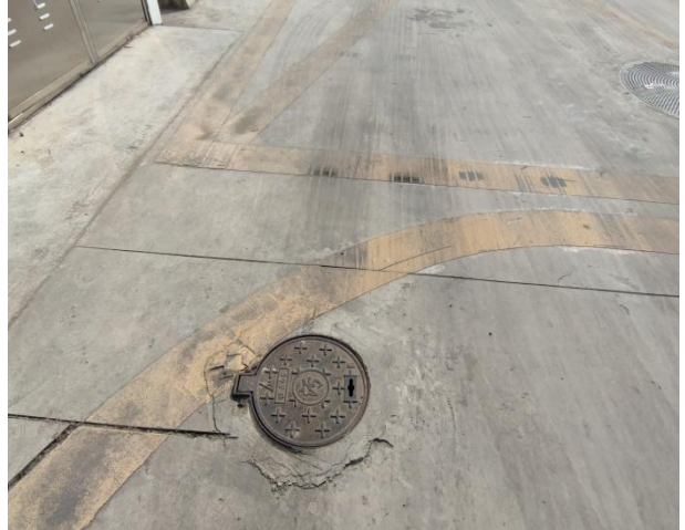
2#地下水监测井
