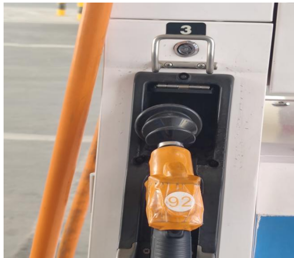
二次油气回收系统
