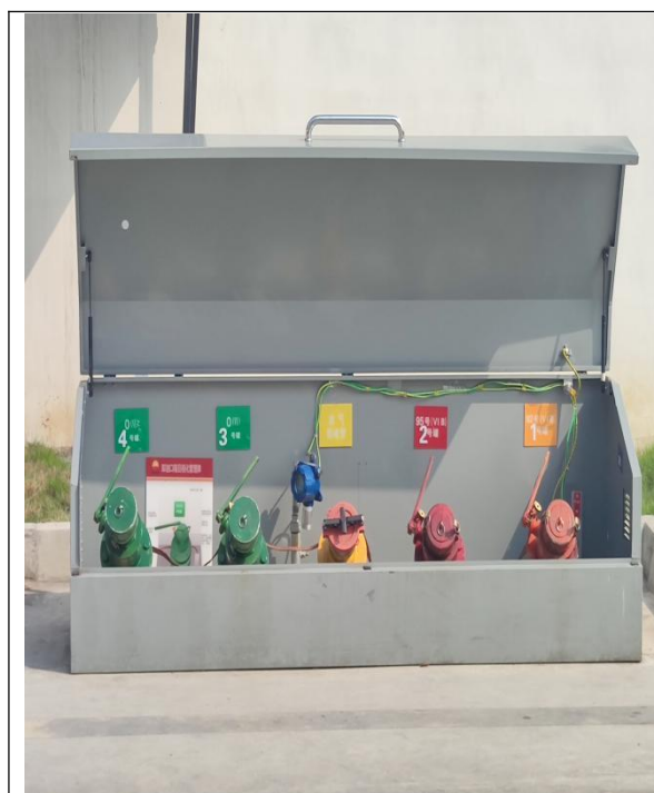
一次油气回收系统
