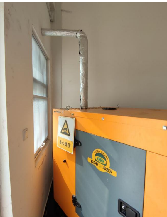
柴油发电机及废气排放管道
