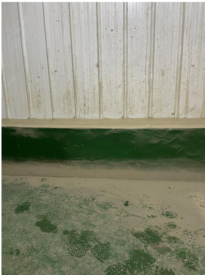
危废间地面防渗+围堰
