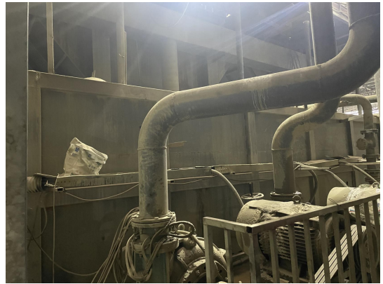
二级沉淀池+污泥池钢结构池体
