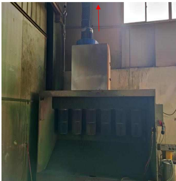
喷塑废气治理装置
