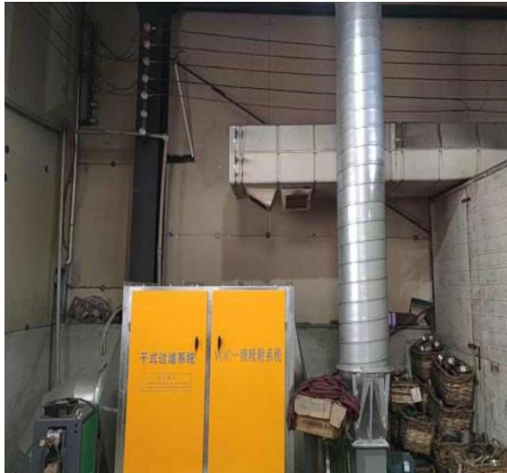
DA002 排气筒及废气净化装置
