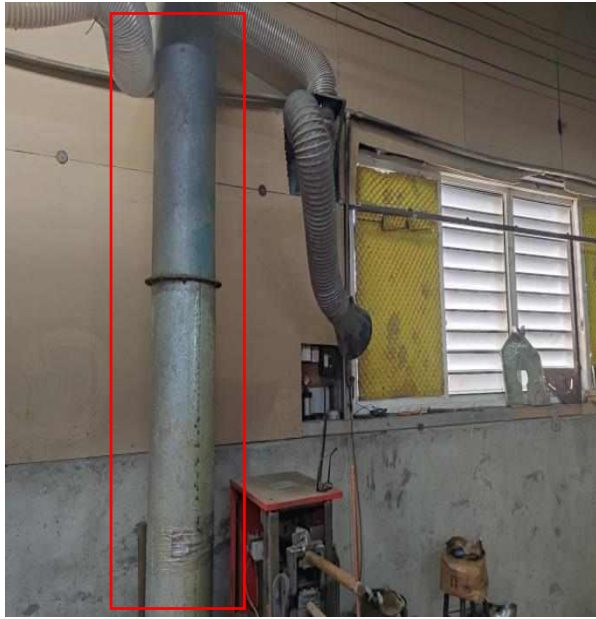
DA001 二楼的排气筒
