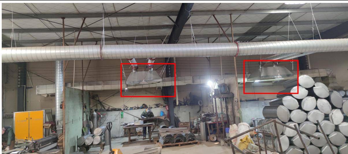
二保焊焊接工位上面的集气罩
