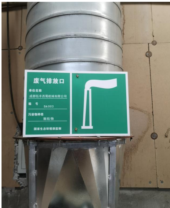
DA003 排气筒环保标识牌
