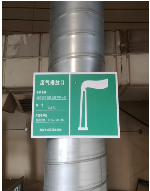
DA002 排气筒环保标识牌
