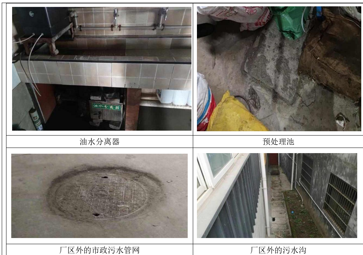
图 3.2 本项目废水治理措施现场照片
