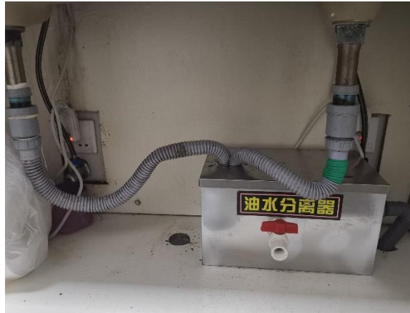
油水分离器（本项目新增，车间洗手池下方）
