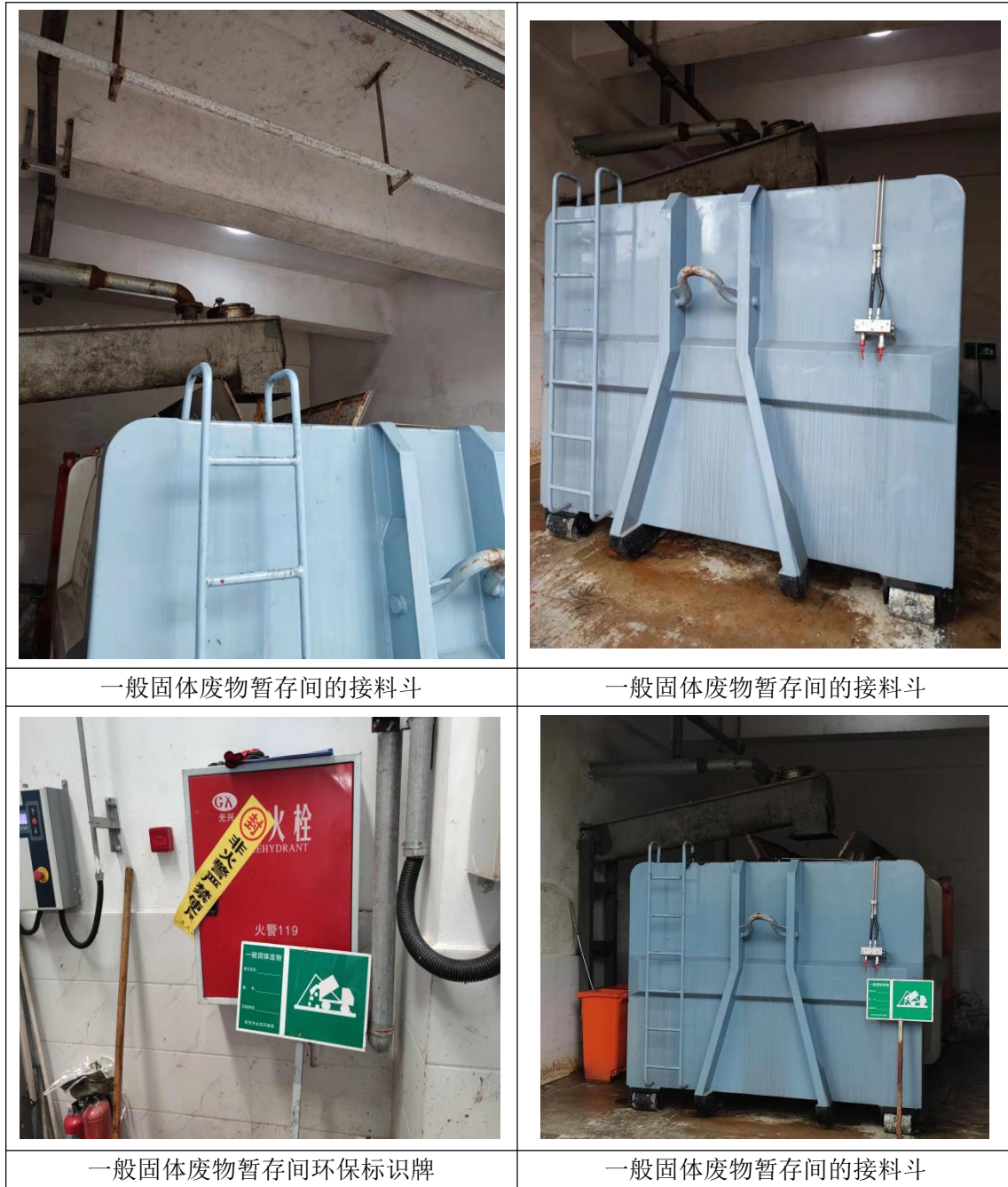
图 4.1-6 固废治理设施现场图
