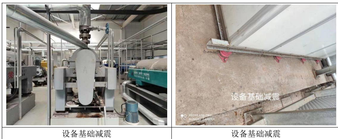
图 4.1-5 噪声治理设施现场图
