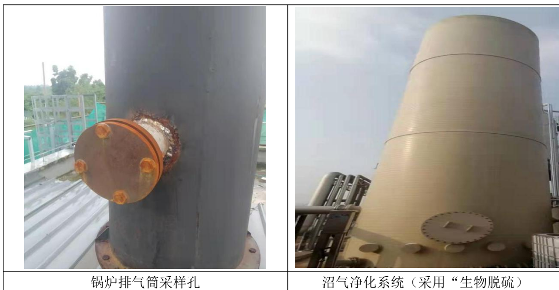
图 4.1-4 本项目废气处理相关现场照片
