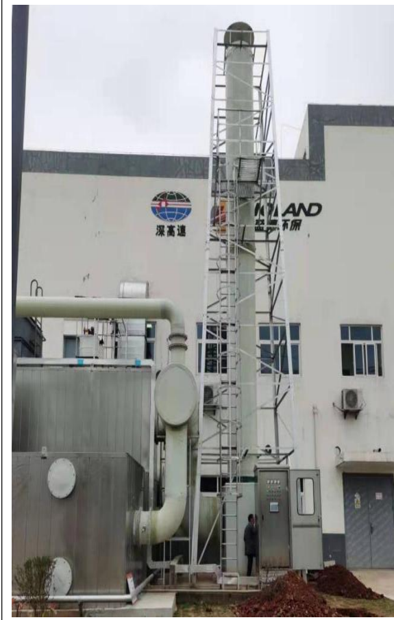
除臭系统排气筒
