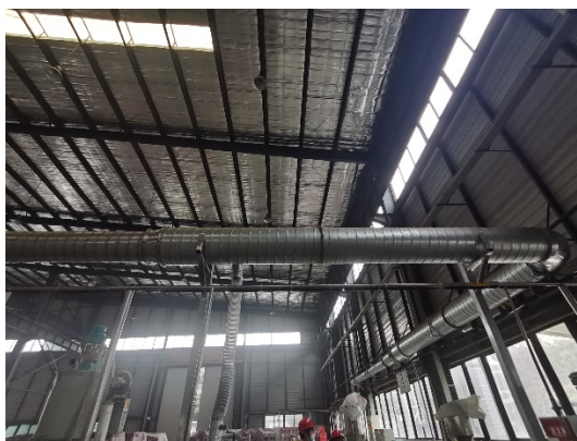
外覆塑废气输送管道
