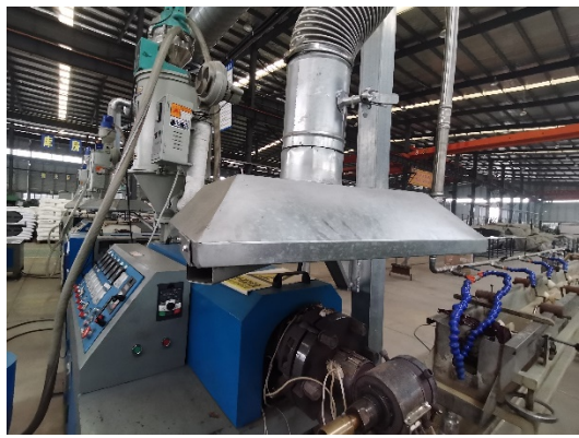
外覆塑生产线有机废气收集装置
