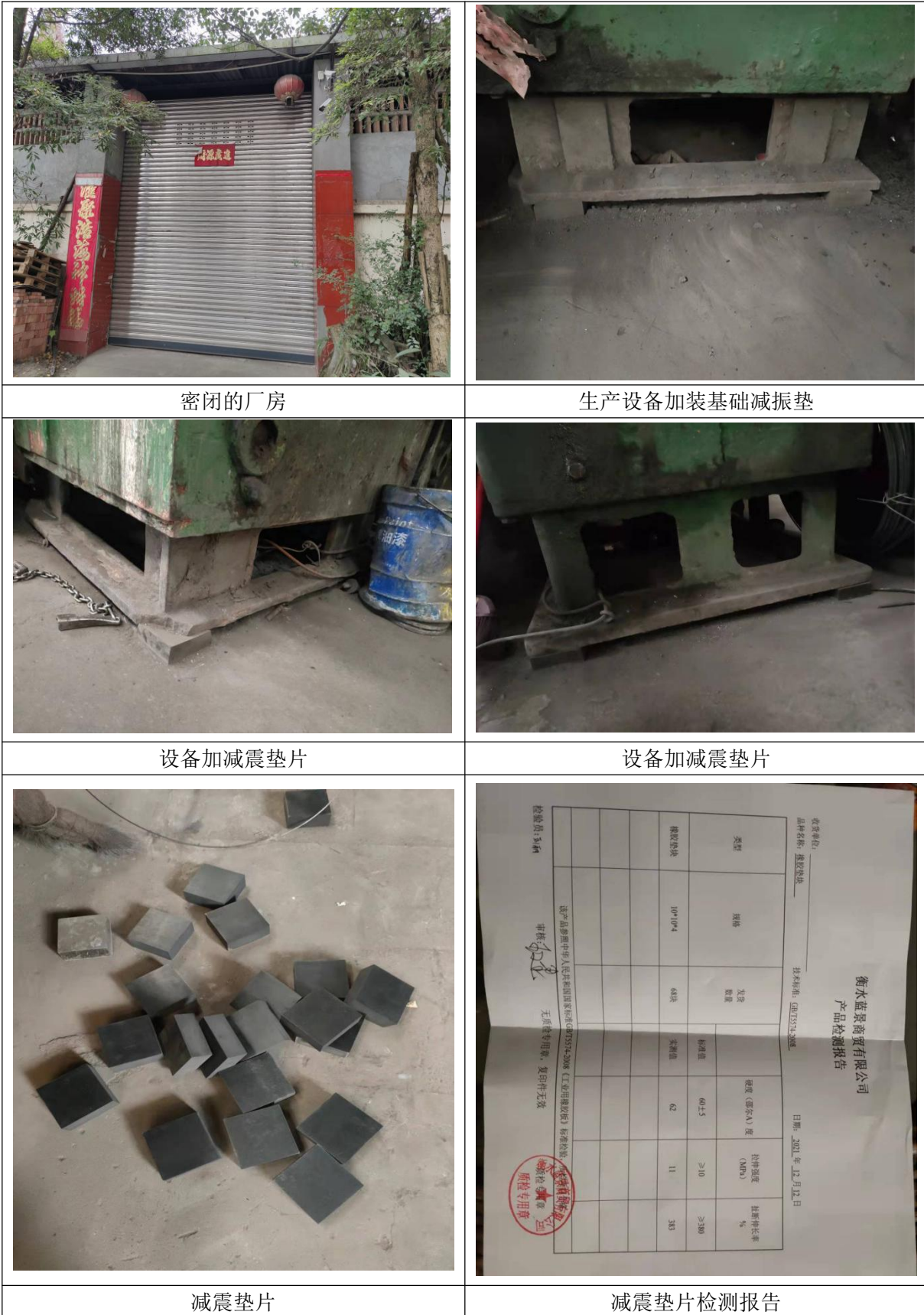
图 3.3 本项目噪声治理措施现场照片
