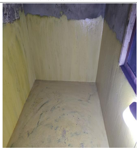
危废暂存间里面的做的防渗
