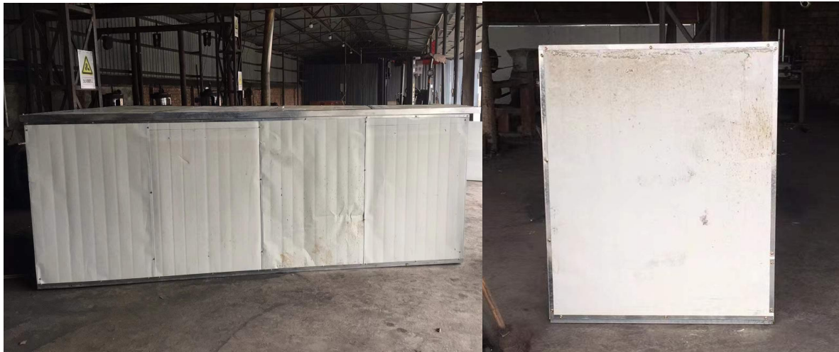
图 3.3 本项目噪声治理措施现场照片
