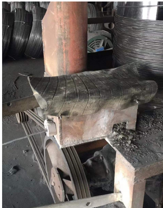
图 3.1 本项目废气治理措施现场照片
