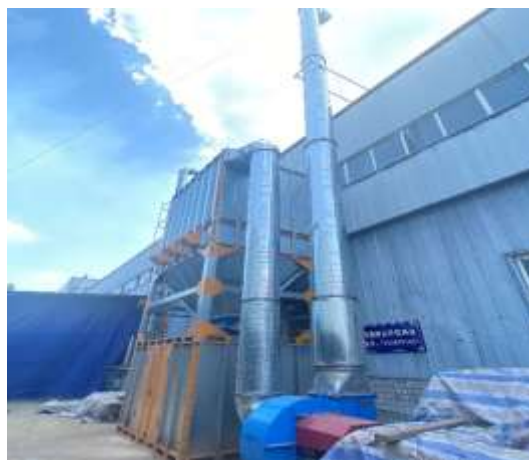
中央除尘器及排气筒
