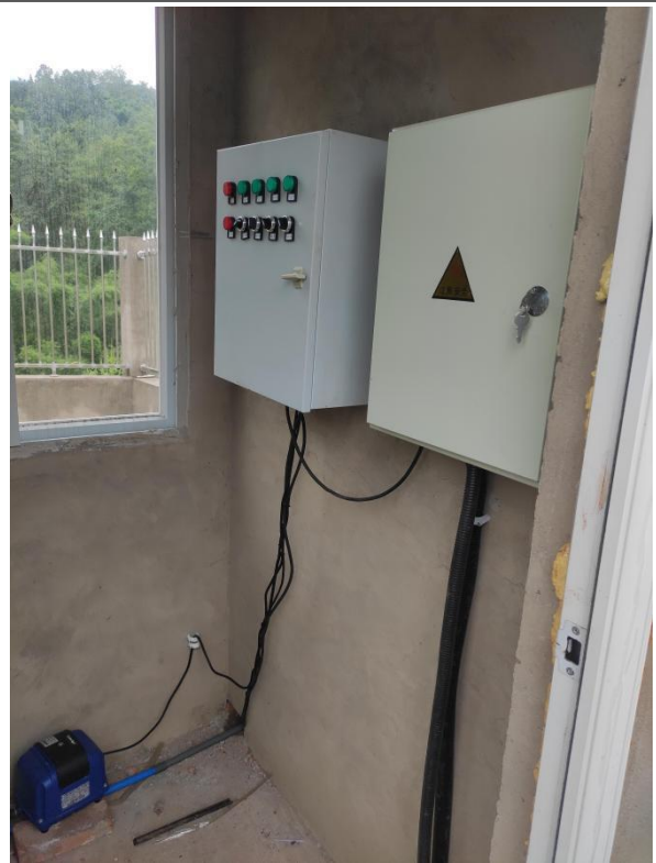
一体化污水处理设施
