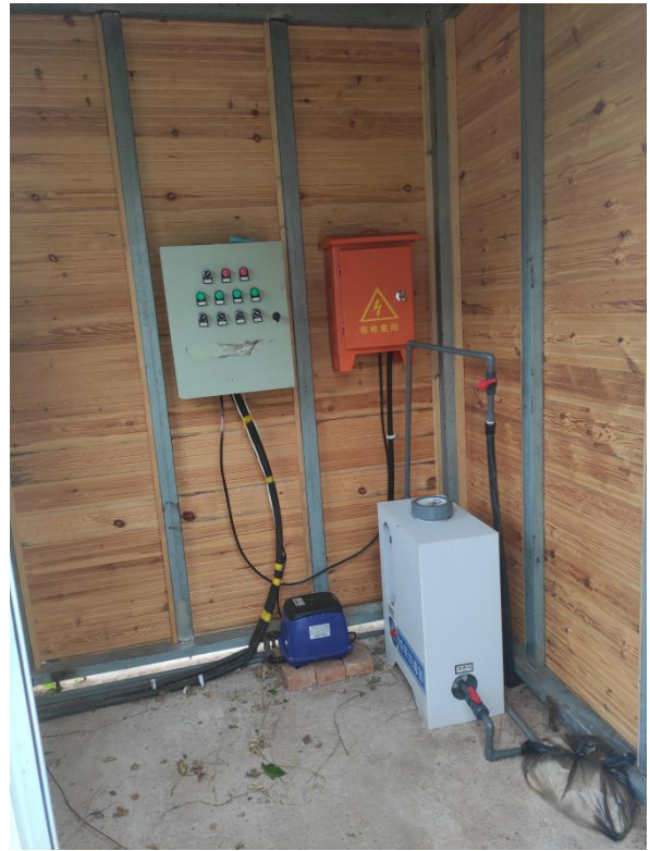
一体化污水处理设施
