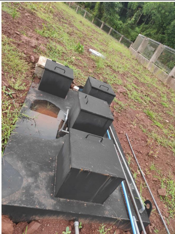
一体化污水处理设施
