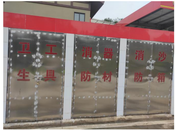
消防沙箱及消防器材（西加油站）
