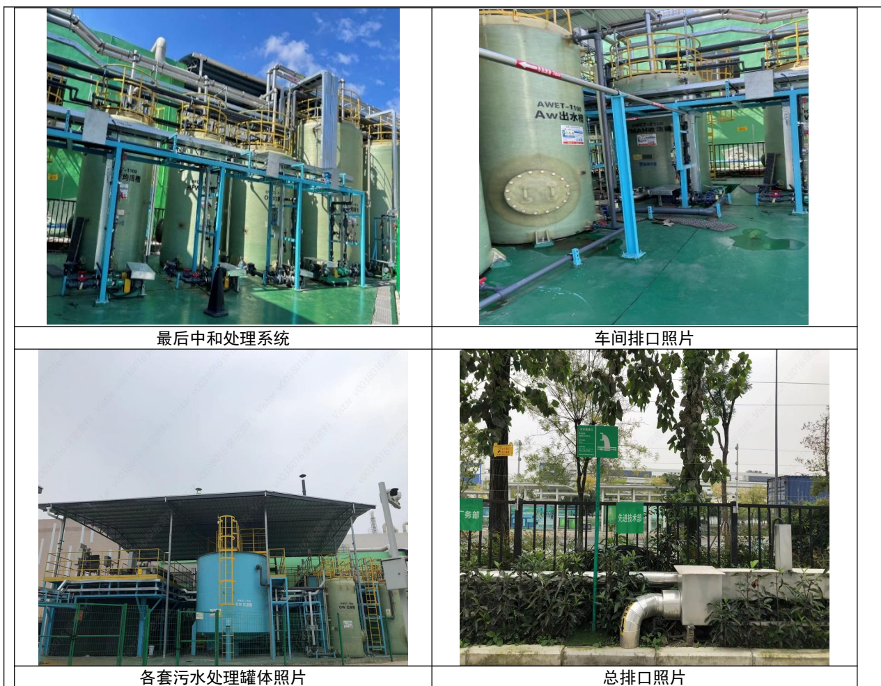
图 3-8 项目污水处理系统及排口
