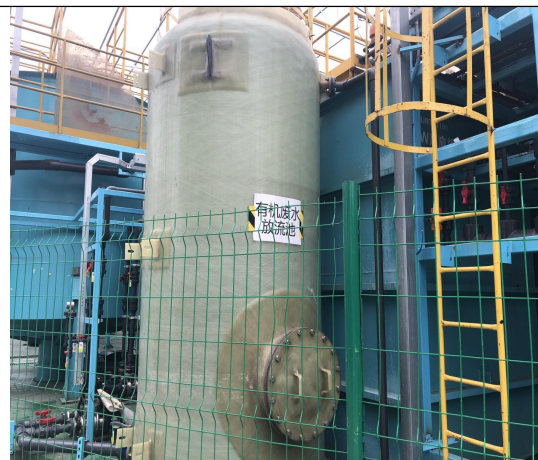
有机废水处理系统
