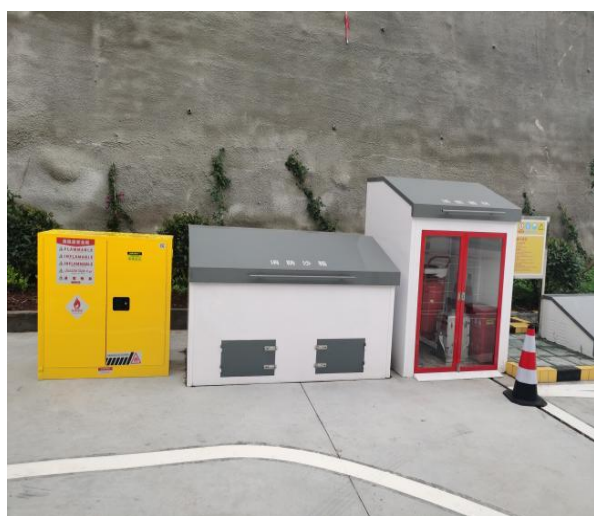
危险品安全柜、消防沙箱、消防器材柜
