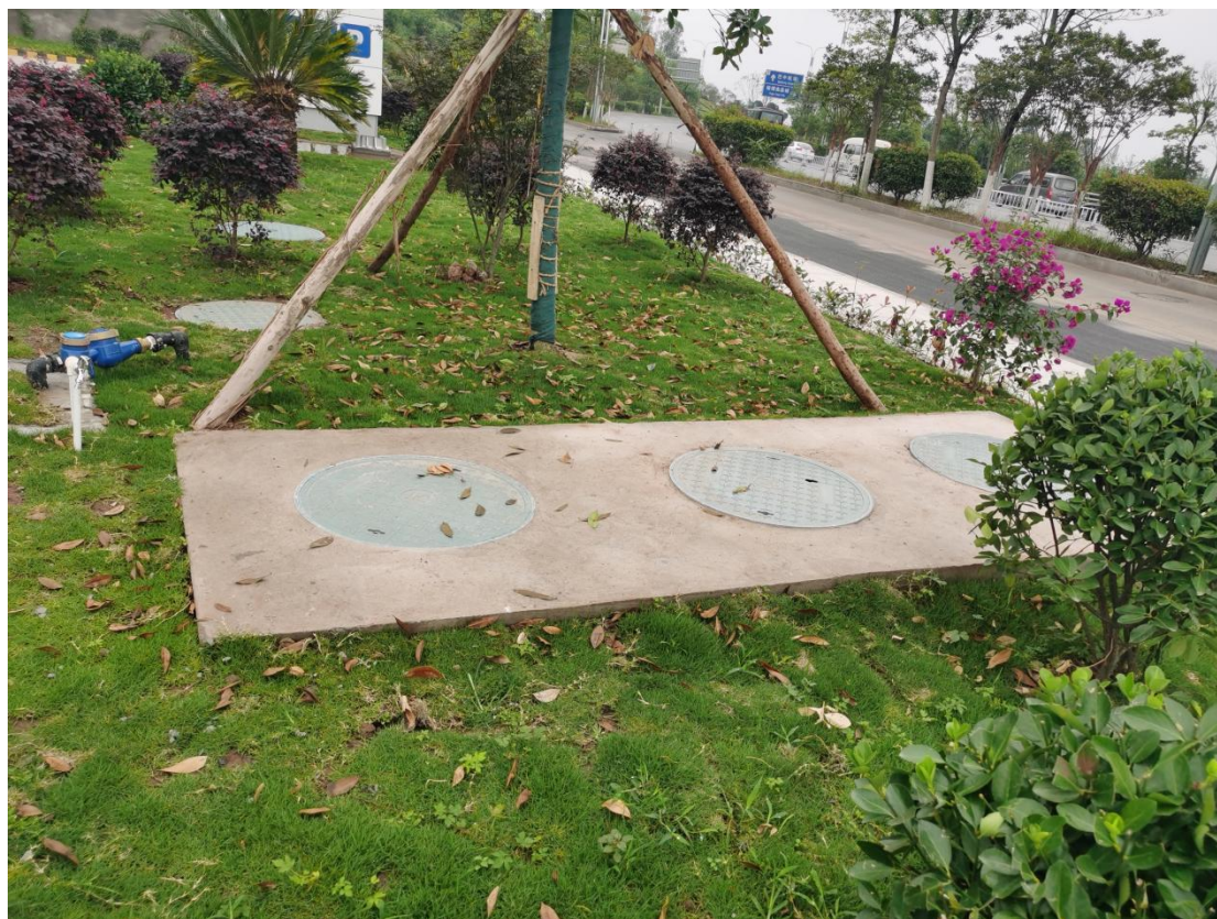
图 3.3 本项目厂区预处理池
