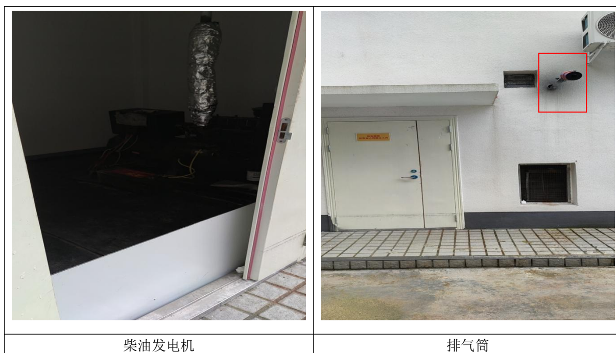
图 3.2 柴油发电机废气收集处理现场照片
