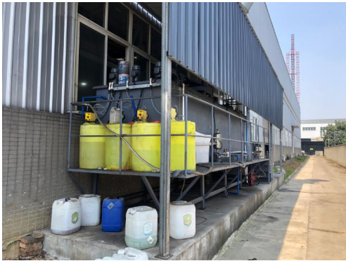
项目废水处理设施
