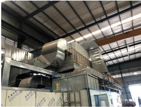
项目废气处理设施
