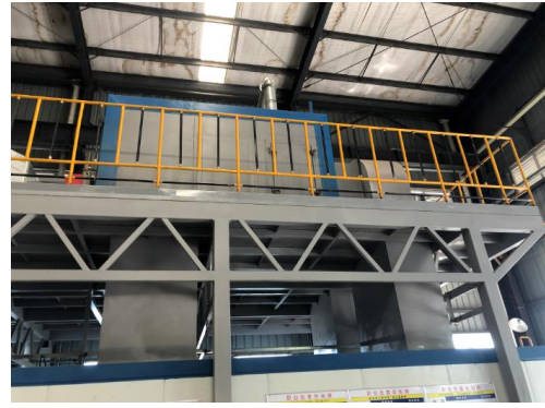
项目废气处理设施
