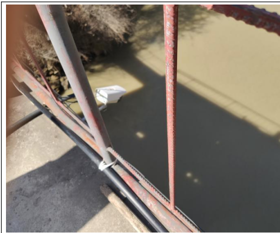
下泄生态流量监控设施
