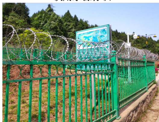
水库护栏及监控设施
