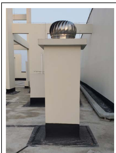
楼顶油烟排放口
