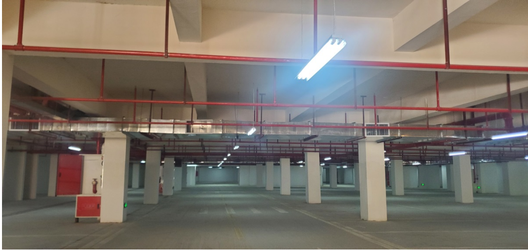
地下车库通风设施
