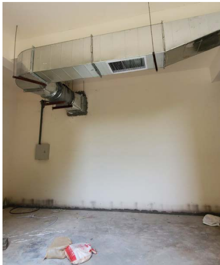
垃圾压缩站废气收集措施
