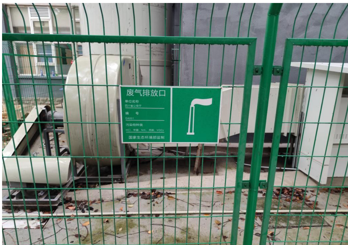
本项目 1#废气排气筒标识
