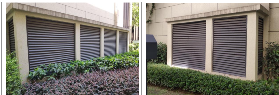
地下车库抽排风系统
